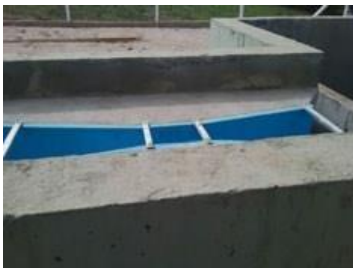
Foto 51: Calha parshall de entrada
