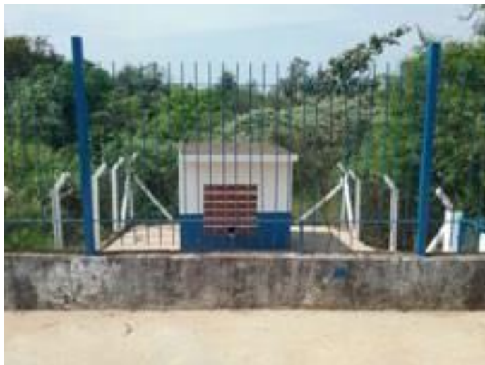
Foto 58: Aspecto externo da elevatória
