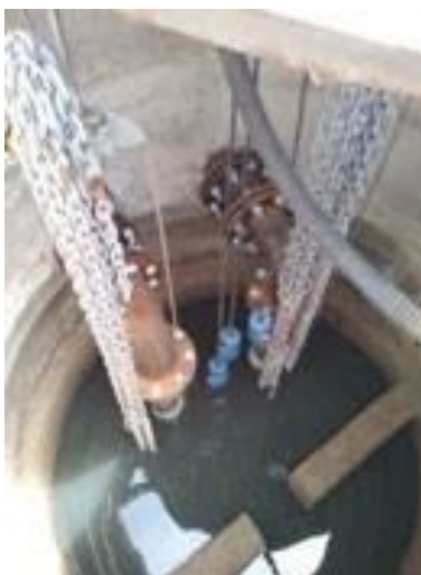
Foto 79: Poço de sucção
