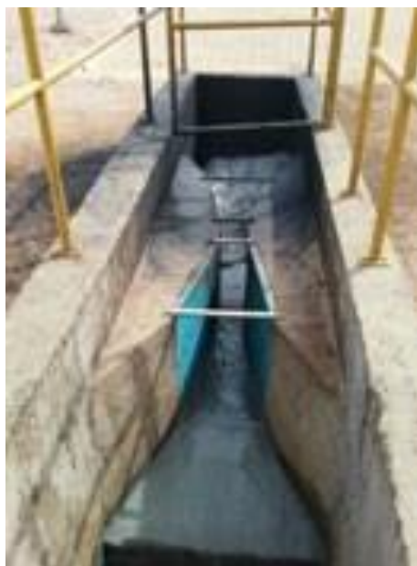
Foto 55: Calha parshall de saída
