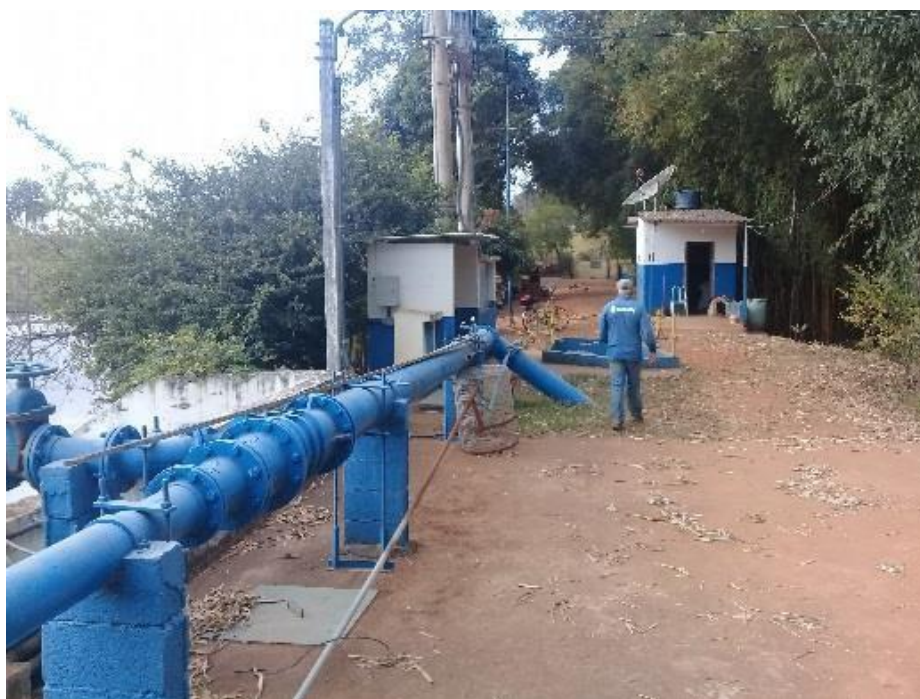
Foto 19: Elevatória – Captação - represa Mariano Batista “Cotrins”.
