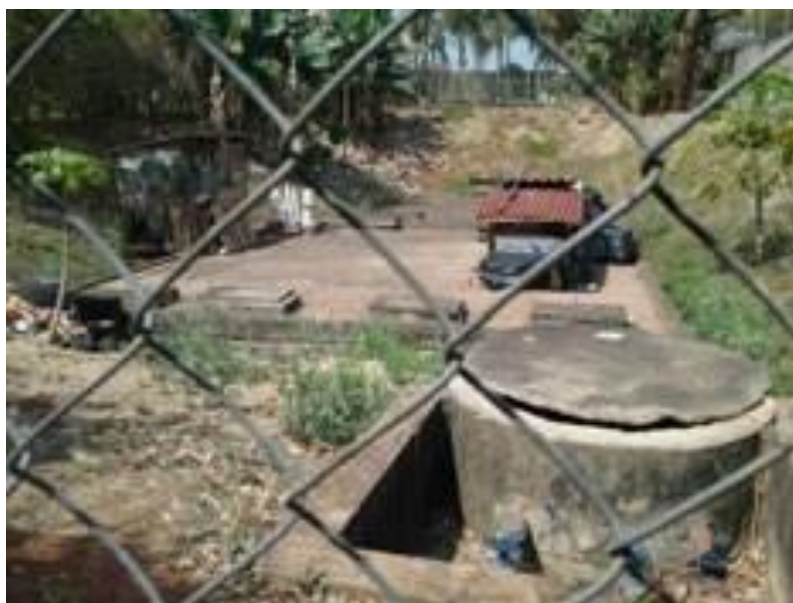
Foto 82: Aspecto geral da elevatória
