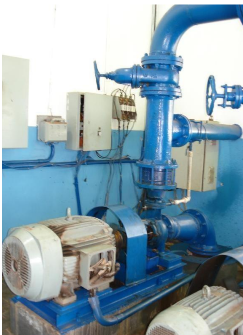
Foto 35: Conjunto Moto bomba – 1 - Elevatória 1.
