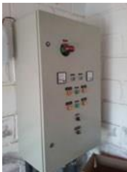
Foto 74: Vista externa do painel elétrico
