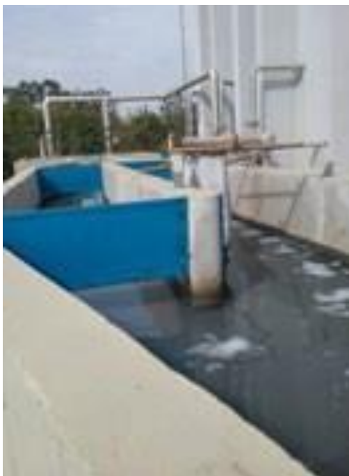
Foto 48: Detalhe dos desarenadores
