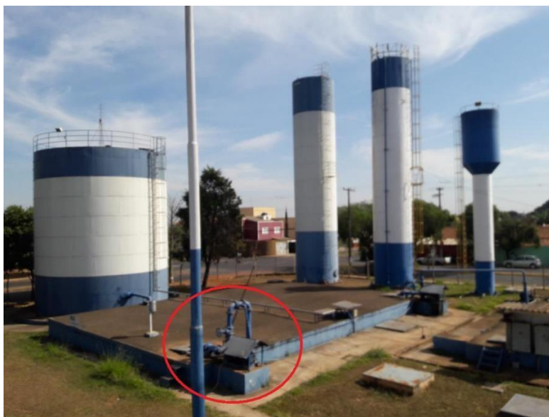
Foto 42: Conjunto Moto bomba - Sistema da ETA III – Elevatória 2.
