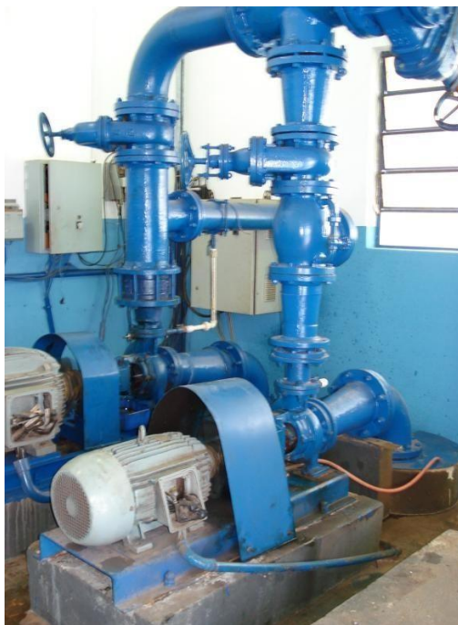
Foto 36: Conjunto Moto bomba – 2 - Elevatória 1.
