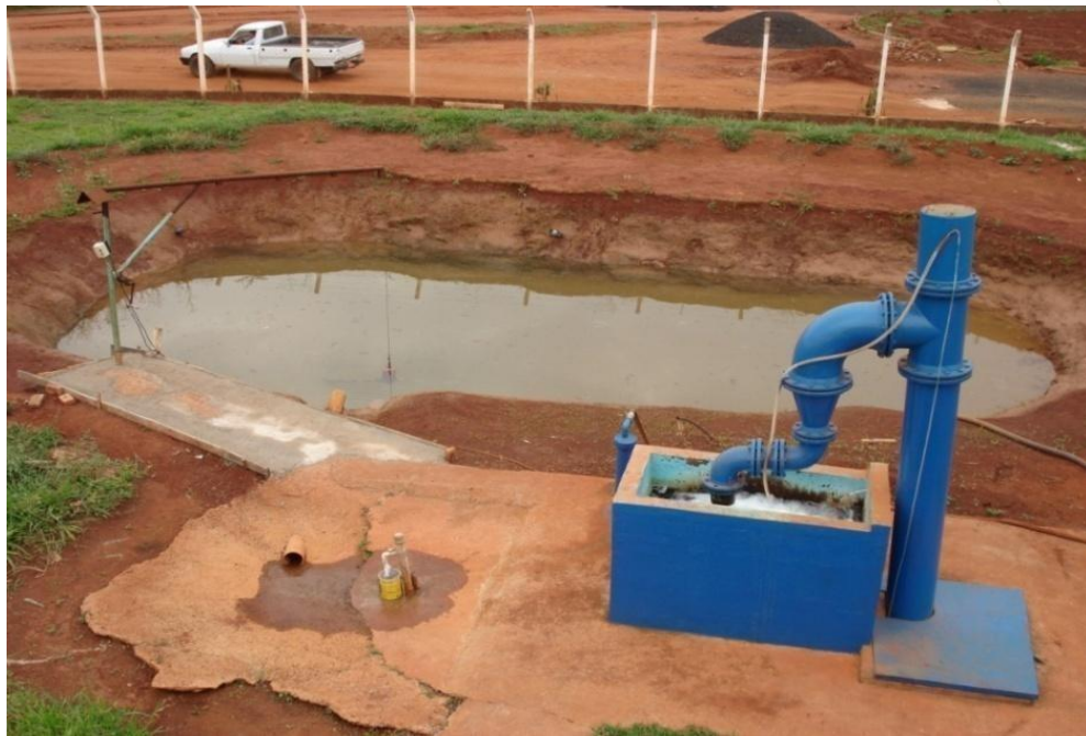
Foto 16: Reaproveitamento de água de retrolavagem.
