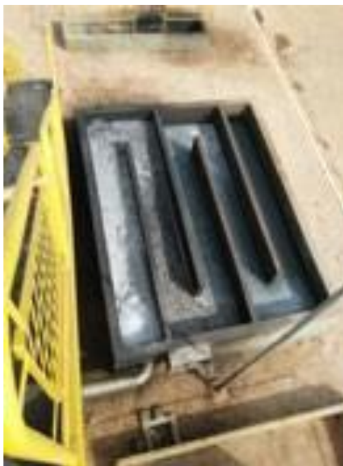
Foto 54: Tanque de desinfecção
