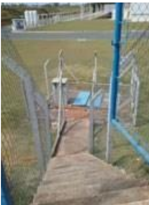
Foto 83: Vista geral da elevatória
