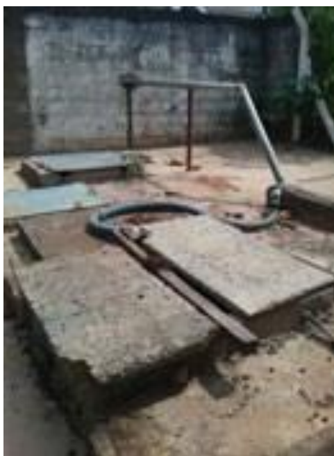
Foto 61: Área interna da elevatória
