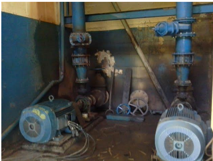
Foto 20: Bombas – Captação - represa Mariano Batista “Cotrins”.
