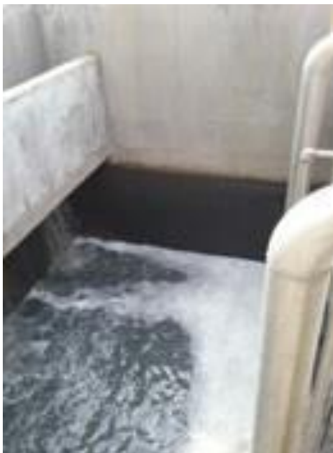
Foto 50: Tubulação de sucção
