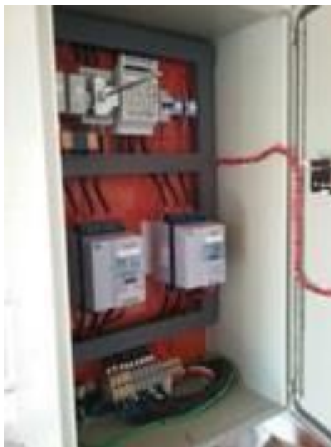
Foto 73: Vista interna do painel elétrico
