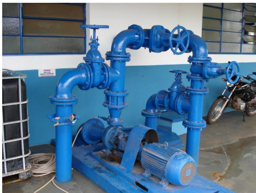
Foto 38: Conjunto Moto bomba – 1 – Elevatória 2.
