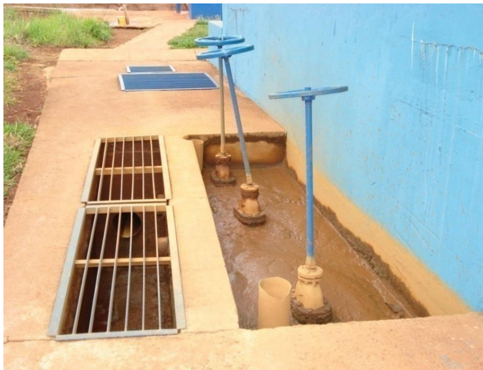
Foto 15: Descarga de lodo dos decantadores.
