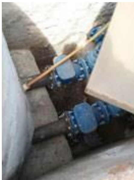
Foto 78: Válvulas de retenção
