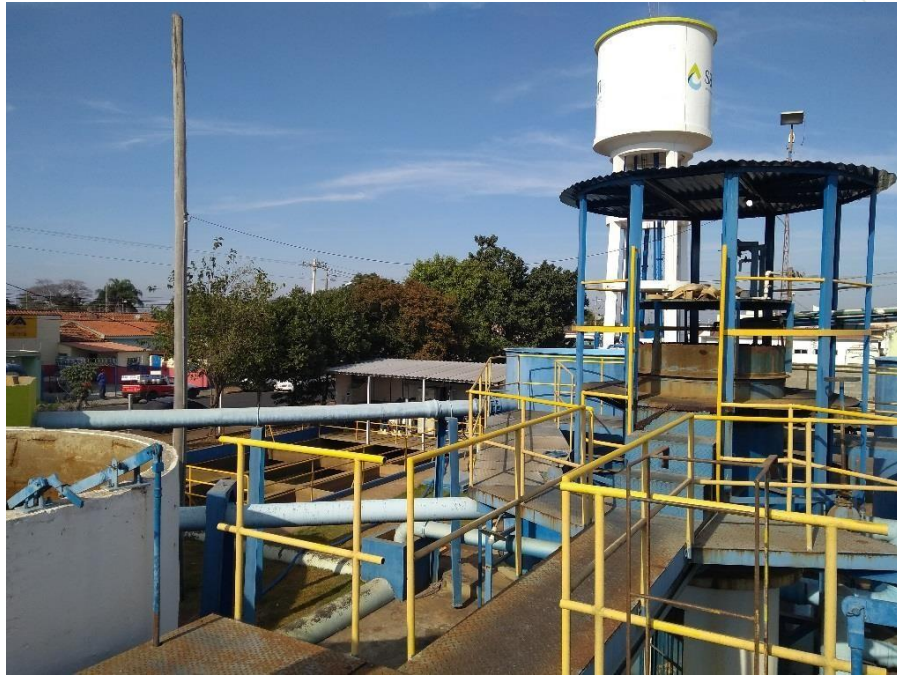
Foto 3: Estação para tratamento de água ETA II.
