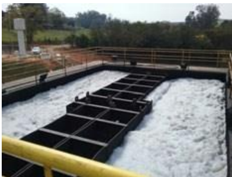
Foto 53: Vista superficial do reator aeróbico e do decantador central
