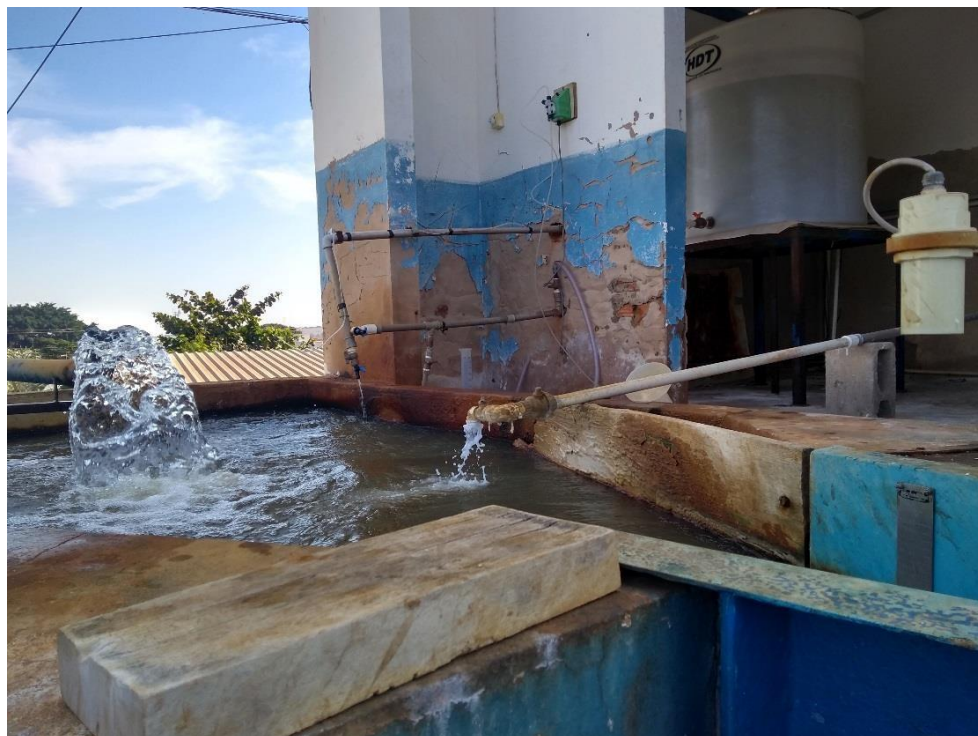
Foto 4: Caixa de chegada de água bruta e dosagem de coagulante. Fonte:
