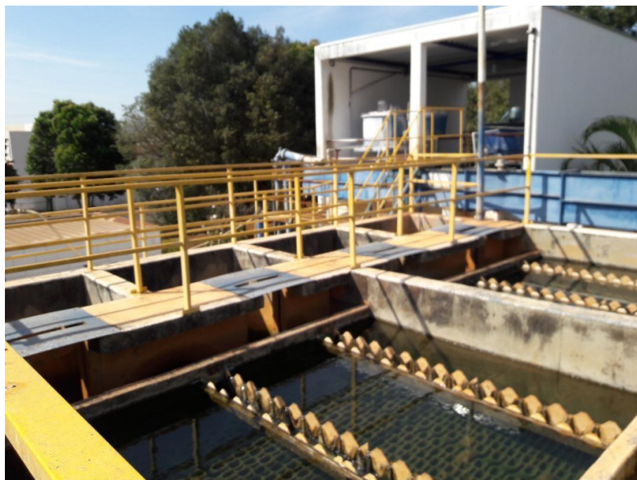
Foto 14: Tanque de decantação.
