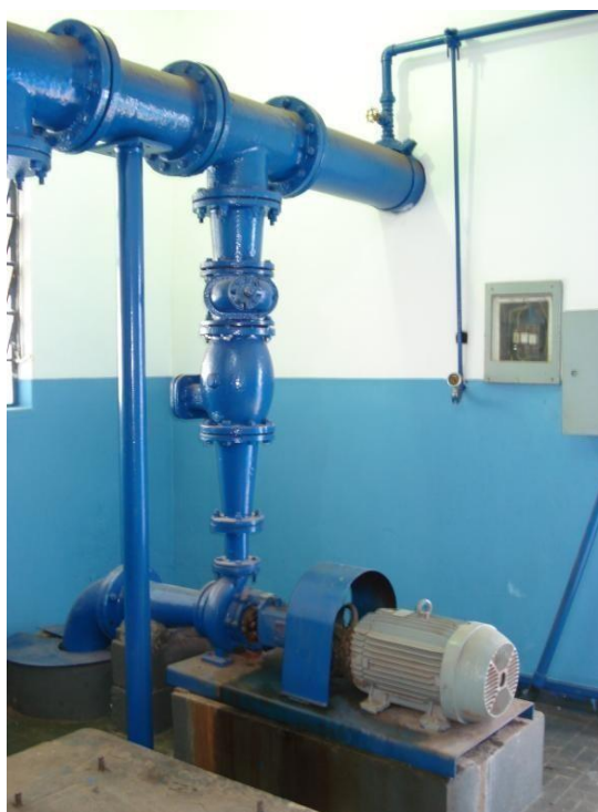
Foto 37: Conjunto Moto bomba – 3 - Elevatória 1.
