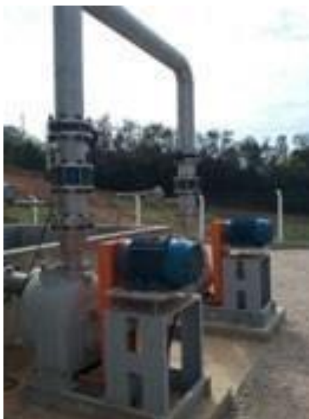
Foto 49: Bombas de recalque do esgoto para o UASB
