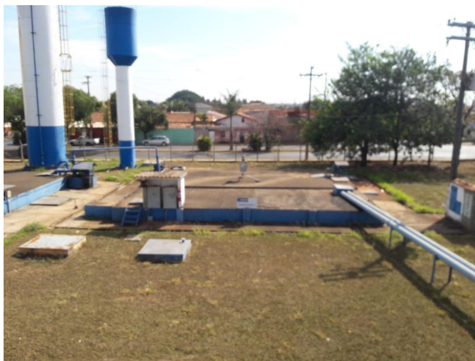
Foto 40: Sistema da ETA III.
