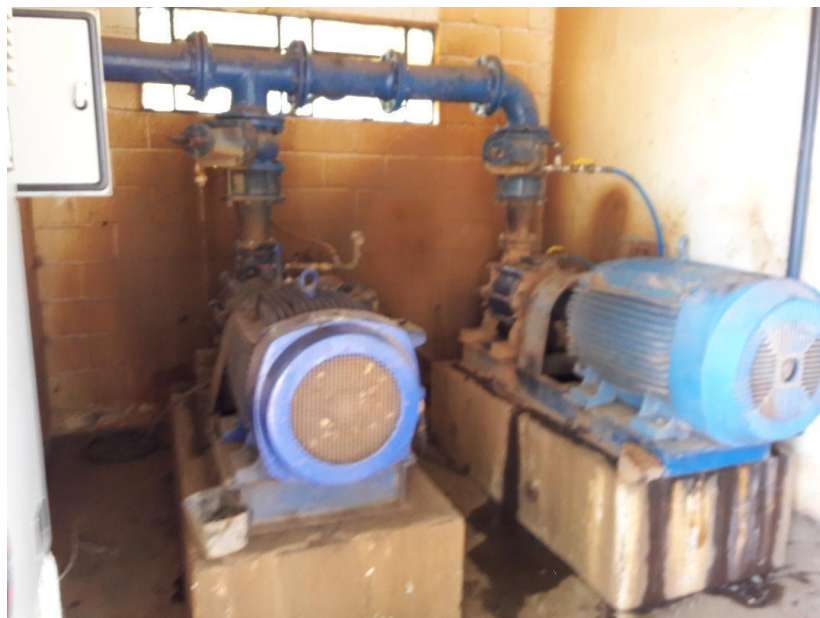
Foto 22: Bombas – Captação Poquinha.
