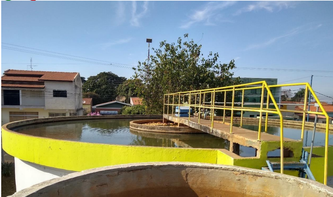
Foto 5: Flocculador Central e Tanque de Decantação periférico
