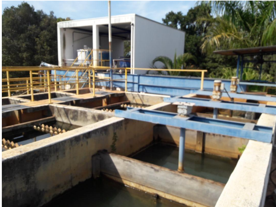
Foto 13: Tanque de Floclulação.
