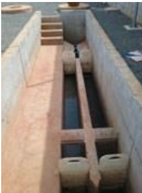
Foto 66: Gradeamento grosseiro e desarenadores
